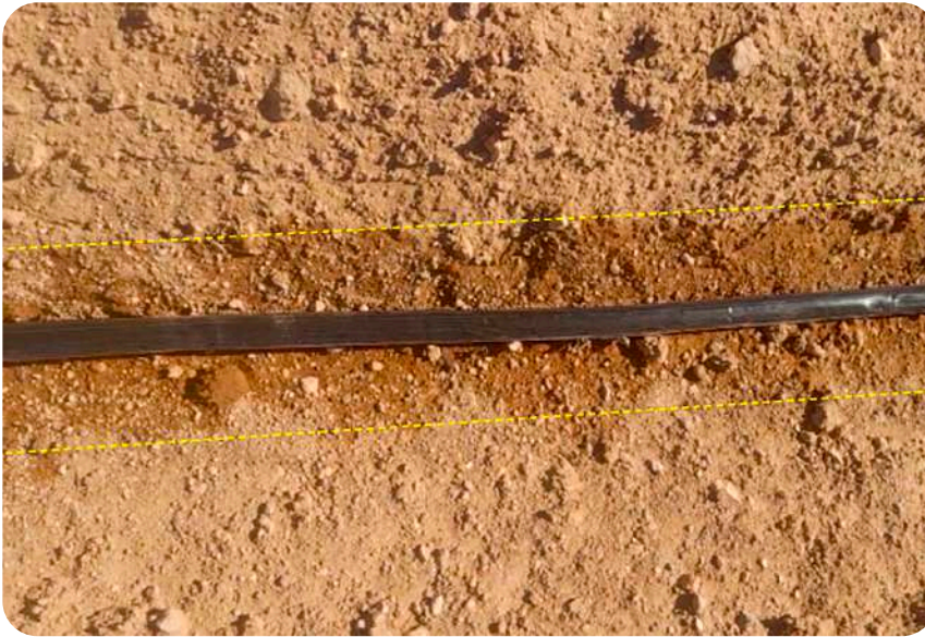
Foto: Finalizada el riego, se observa una zona húmeda alrededor del emisor (gotero)
